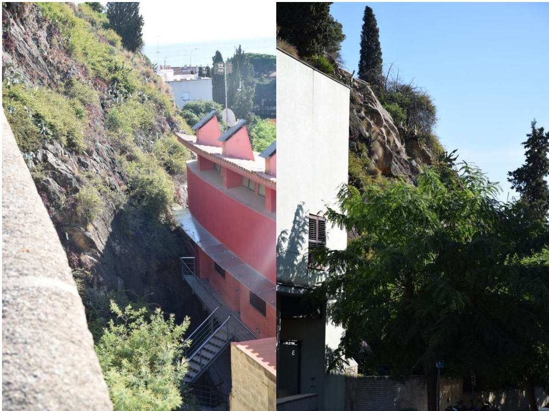
Fotografia 6. Punt 1. Esquerra: habitatge situat al Camí Ral nº45, just al peu del talús. Dreta: vista del mateix talús des del Camí Ral.
