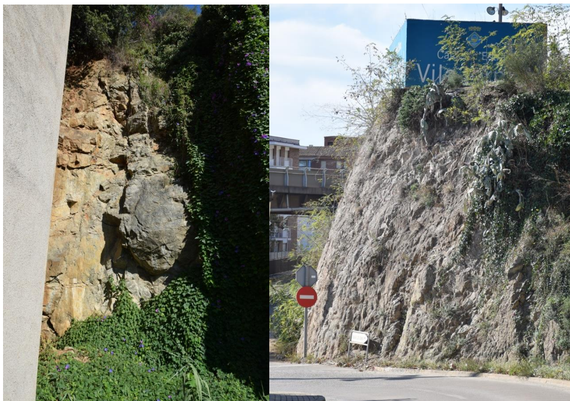
Fotografia 10. Esquerra: talús en el punt 3. Dreta: talús a la cruïlla entre el carrer de l'Estació i el Camí Ral (punt 6).
