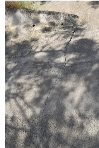
Fotografia 18. Punt 5: Detall esquerra en formigó projectat.
