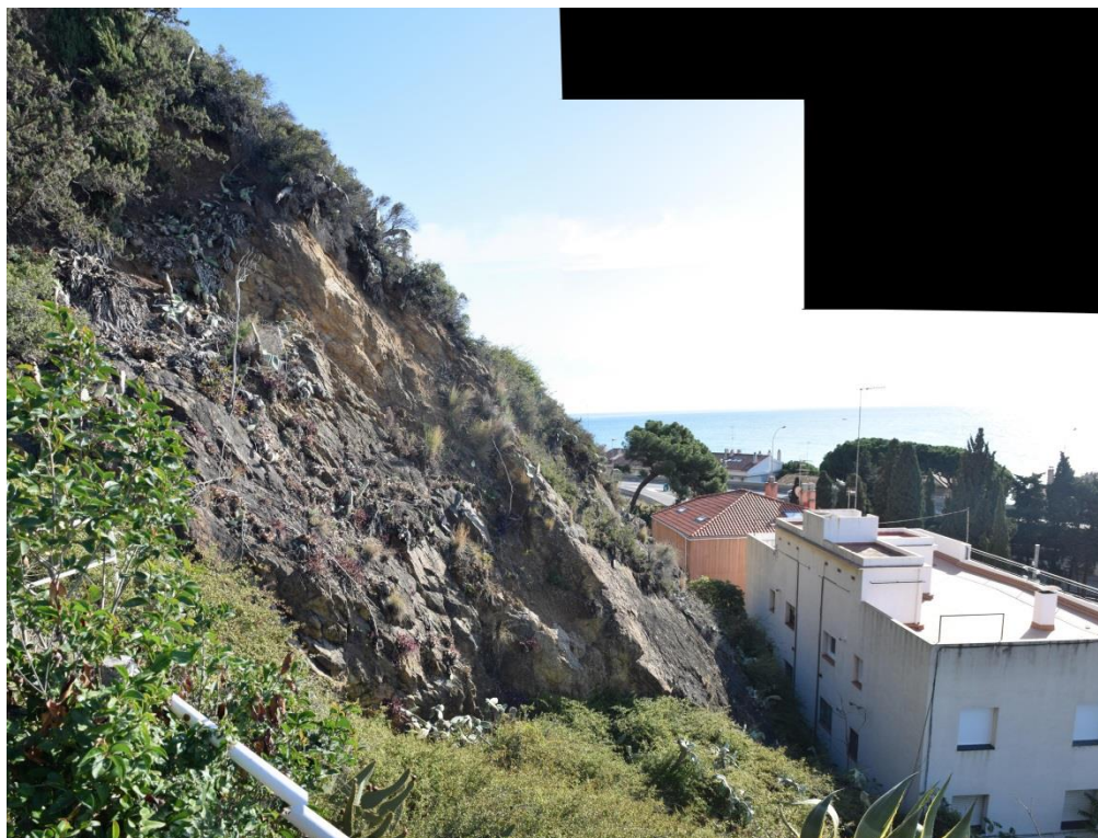
Fotografia 7. Punt 1. Vista panoràmica on es pot veure el talús darrera del habitatge situat al Camí Ral 43. L'edifici color rosat del costat es troba en el terme municipal d'Arenys i també estaria afectat per blocs que es poguessin desprendre's des del talús.
