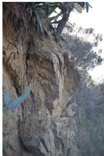
Fotografia 15. Punt 2: Detall de blocs inestables.
