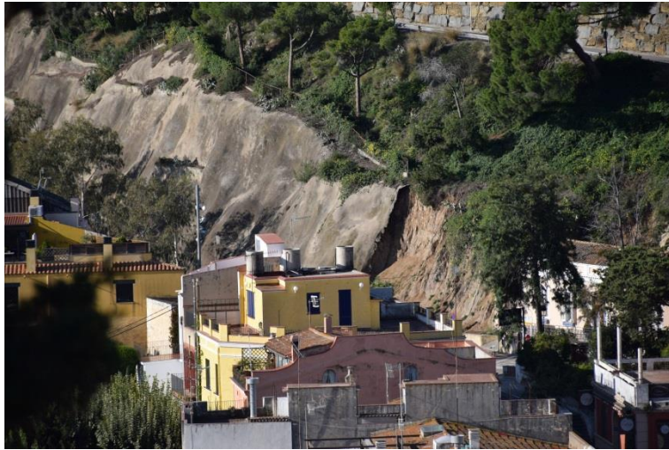
Fotografia 17. Punt 5: Pèrdua de material darrera del formigó projectat.
