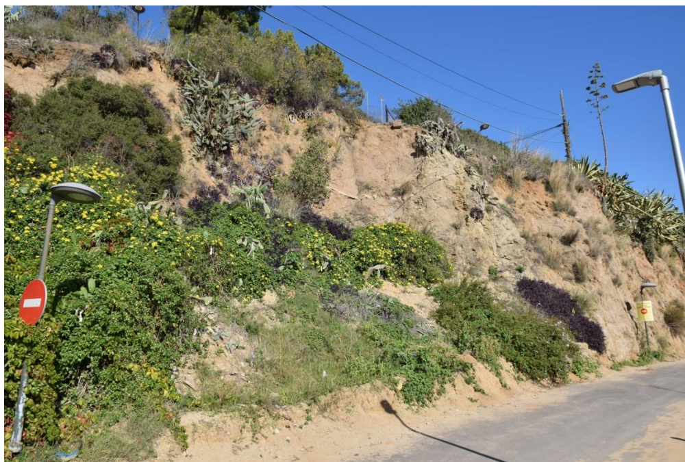
Fotografia 4. Talús a la baixada del Pont del Sergent on es pot observar el massís rocós alterat i per tant susceptible de patir petites esllavissades que s'acumulen al peu.
