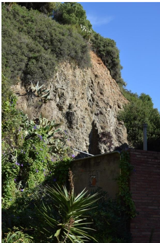
Fotografia 11. Punt 7: estat del talús existent darrera del complex esportiu municipal. A la zona d'ombra es pot apreciar la proximitat dels edificis del complex.
